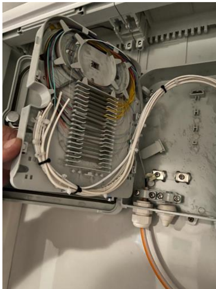
Fig. 1 – Esecuzione estremamente discutibile delle intestazioni fibre verso gli appartamenti
